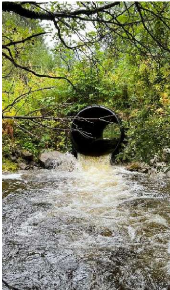
Figur 2-9: Stikkrenne som fungerer som potensielt vandringshinder for små ørret.
