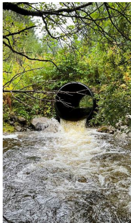
Figur 5-10: Stikkrenne som fungerer som potensielt vandringshinder for små ørret.
